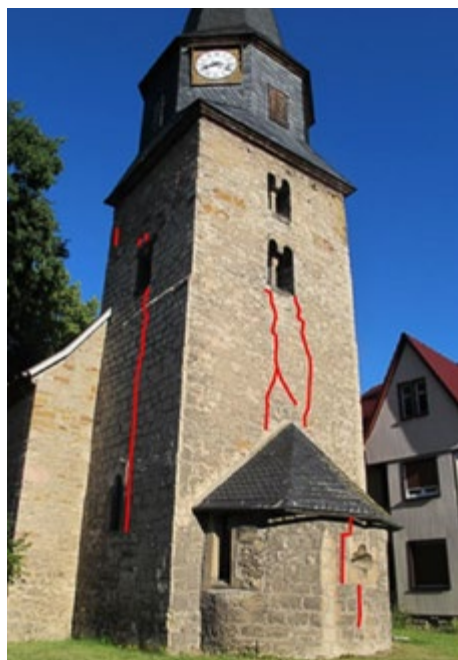
Mit Rot markierte Risse im Kirchturm Windischholzhausen
